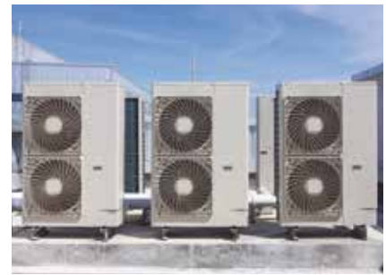
Vifte- og ventilasjonsaggregat
