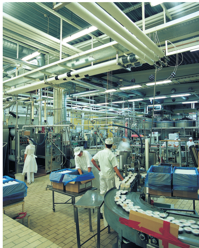
Industri-installasjon ved Hennig Olsen AS
