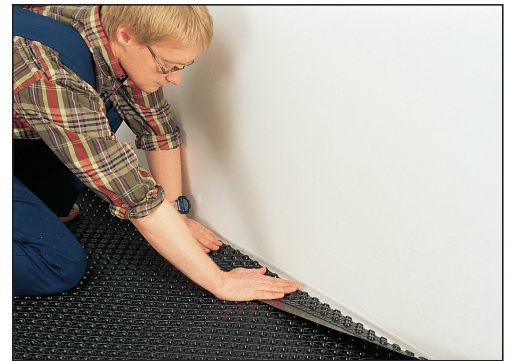
Enkel oppbrett ved kanten.
