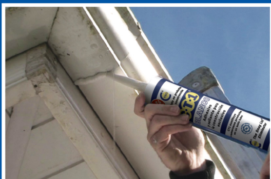
Reparerer umiddelbart takrenner som lekker
