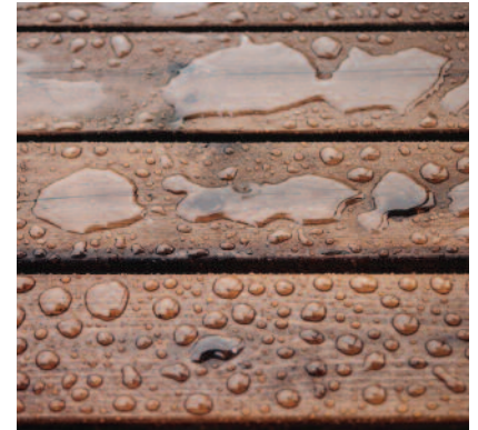
Nylig overflatebehandlet og utsatt for regn.
